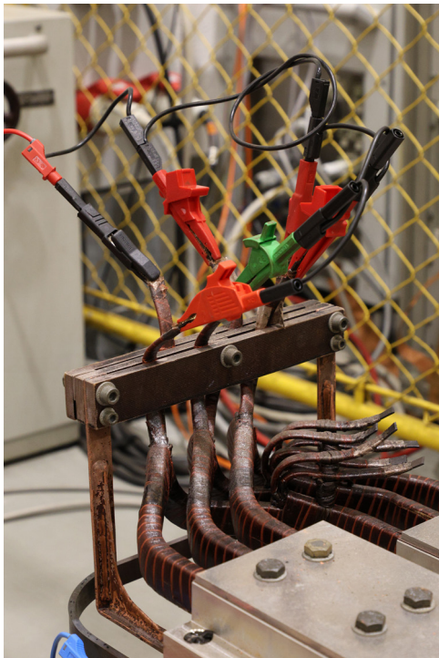
Detailansicht bei der elektrischen Prüfung
